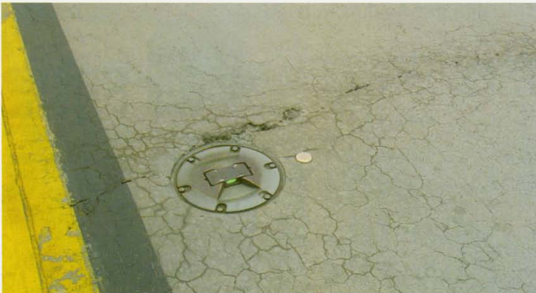
Pavimento de concreto com fissuração típica devida à RAA ( crédito: Fournier, 2005)
